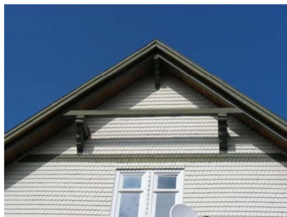
Abbildung 25: Typisches gründerzeitliches Baudetail der vorspringenden Pfetten mit Kopfbändern, die ansonsten für die Region untypisch sind, Oberellenbach
